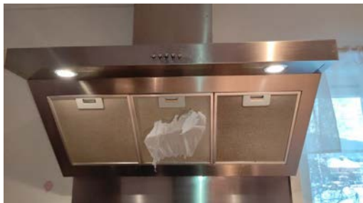
Funksjonstest av ventilator.
