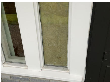
Knust/sprekk i glass.
