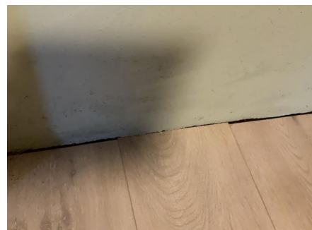
Ingen bevegesfuge/rom mot mur ved pipe underetasje.
