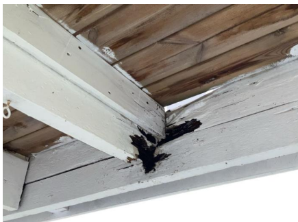
Råteskade på balkongbjelke/rekkverk.
