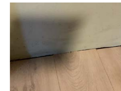
Ingen bevegelsesfuge/rom mot mur ved pipe underetasje.
