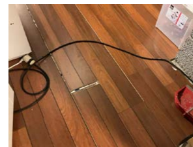
Gulv har glipper mellom skjøter på bod.
