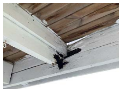
Råteskade på balkongbjelke/rekkverk.
