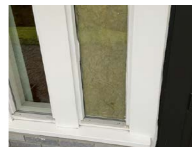
Knust/sprekk i glass.
