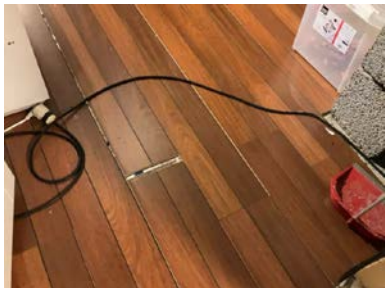
Gulv har glipper mellom skjøter på bod.
