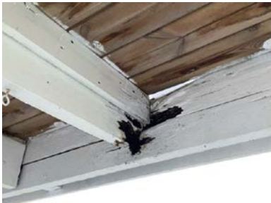
Råteskade på balkongbjelke/rekkverk.
