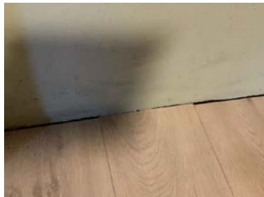
Ingen bevegesfuge/rom mot mur ved pipe underetasje.
