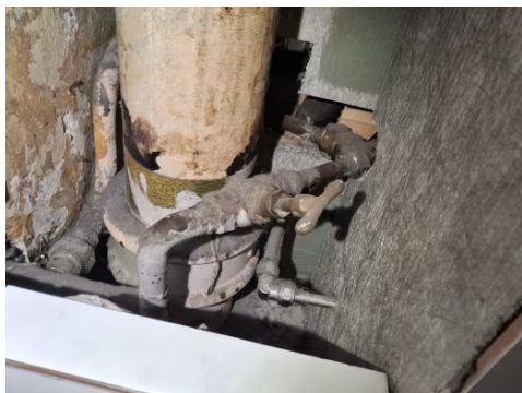
Hovedstoppekrane er plassert i sjakt på bad.
