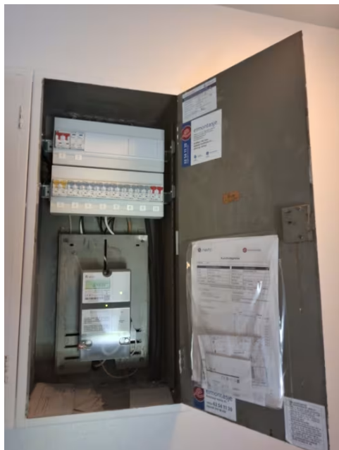
Sikringsskap er plassert i felles trappeoppgang.
