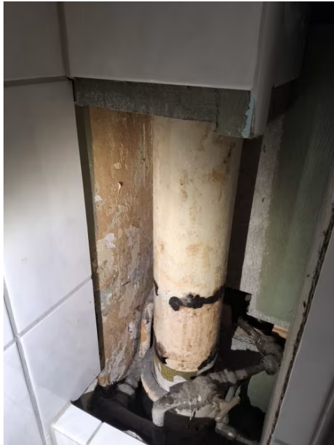
Synlige avløpsrør av støpejern.
