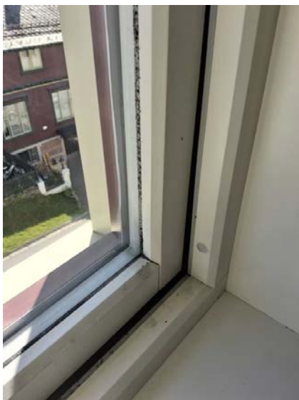
Det registreres symptomer på kondens på vinduer (svertesopp på pakninger).
