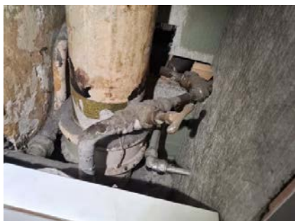
Hovedstoppekran er plassert i sjakt på bad.
