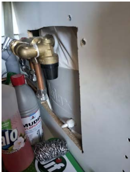
Varmtvannsberederen er innbygd i kjøkkeninnredningen.
