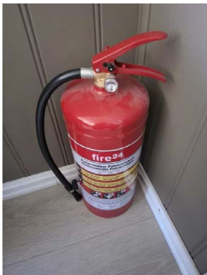
Brannslukningsapparat er plassert på hovedsoverom.
