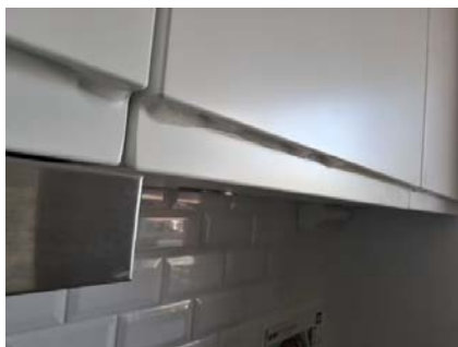
Det registreres folieslipp op enkelte kjøkkenfronter.
