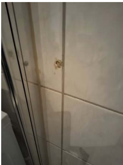
Hull etter tidligere innfestninger i dussjonen.
