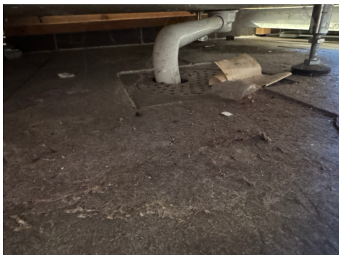
Sluk under dusjkabinett
