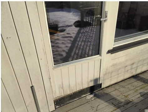
Bilde av terrassedør hvor det er fukt og råteskader
