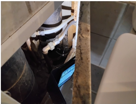
Røropplegg inne i kasse på badet
