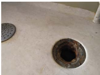
Eldre soilsluk på vaskerommet
