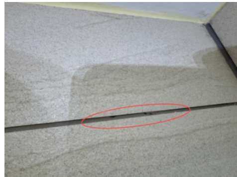
Foto viser sprekk i flisfuge.
