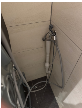
Foto viser røropplegg for vaskemaskin.
