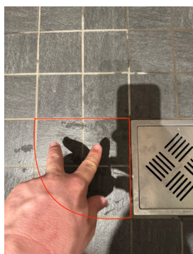
Foto rød trekant, markerer hvor bom er observert under flis ved sluk i dusjsonen.
