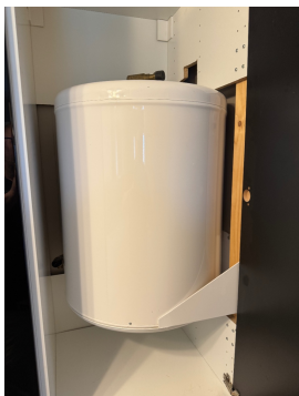
Foto viser hvor varmtvannsbereder i kjøkkenskap.
