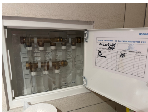
Foto viser fordelerskap for rør-i-rør system på bad.
