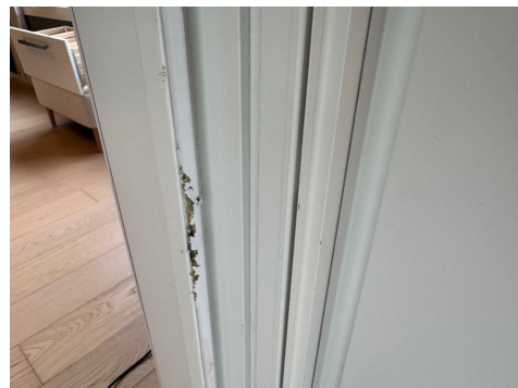
Foto viser skader i pakning balkongdør.
