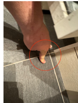
Foto rød ring, markerer hvor bom er observert rundt toalett.
