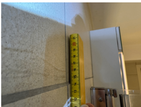
Foto viser sprang mellom fliser på vegg.
