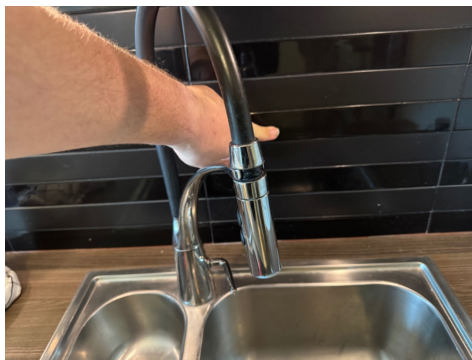
Foto viser hvor bom bak flis er påvist ved vask.
