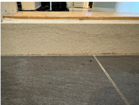
Foto viser ved dørterskel er ikke membran synlig, svelling/ skader i nedre kant dør.
