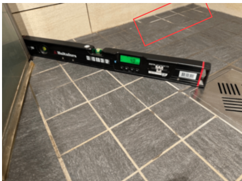
Foto viser kontroll av fall mot sluk, ca. 4 mm/m. Saltutslag inn mot vegg.
