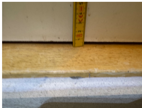
Foto viser spalte under dør, ca. 7 mm.
