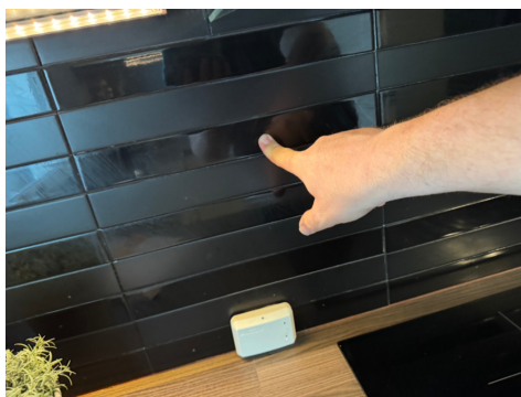
Foto viser hvor bom bak flis er påvist ved platetopp.
