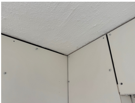
Foto viser manglende skruer på plater.
