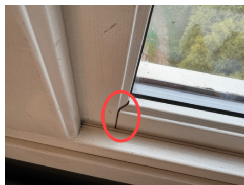
Foto viser skade i lukkekarm.
