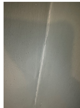
Mindre riss i hjørne registrert.
