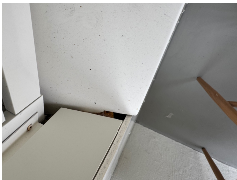
Foto viser utetthet mellom beslag og fasadeplater under vindu.
