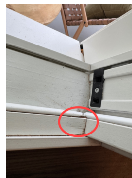
Foto viser skade i karm, kan legges til utetthet i overgang fasadeplater/ utvendig belistning - se andre utv. forhold.
