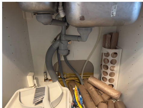
Foto viser kobberanlegg, kjøkkenskap.
