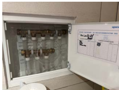
Foto viser fordelerskap for rør-i-rør system på bad.
