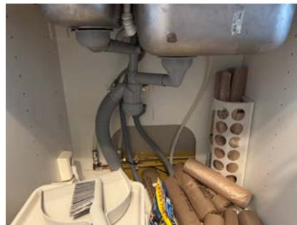
Foto viser kobberanlegg, kjøkkenskap.
