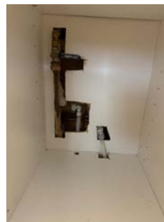
Foto viser stoppekran og tverrkobling mellom plast og kobber.
