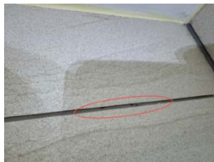
Foto viser sprekk i flisfuge.
