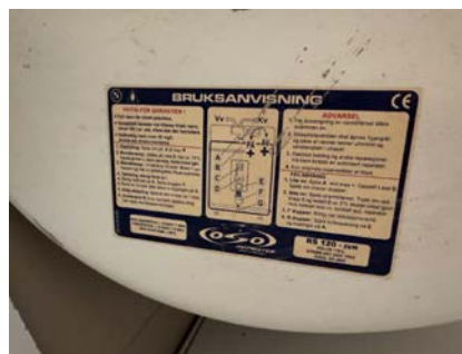
Foto viser bruksanvisning/ infoskjema på varmtvannstanken.
