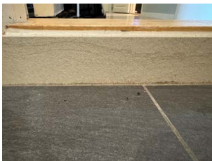
Foto viser ved dørterskel er ikke membran synlig, svellinger/ skader i nedre kant dør.
