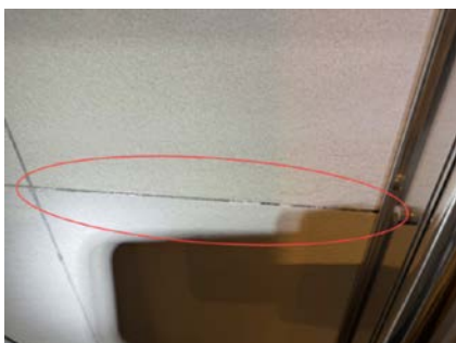
Foto viser saltutslag i fuger på vegg utenfor dusjsonen.
