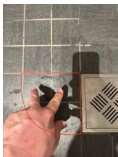
Foto rød trekant, markerer hvor bom er observert under flis ved sluk i dusjsonen.
