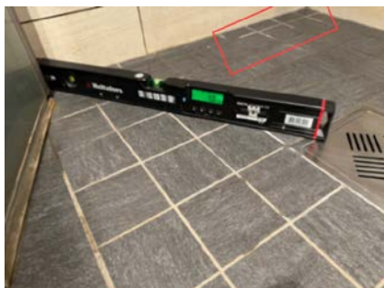
Foto viser kontroll av fall mot sluk, ca. 4 mm/m. Saltutslag inn mot vegg.
