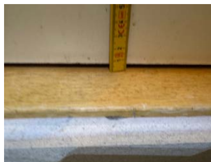
Foto viser spalte under dør, ca. 7 mm.
