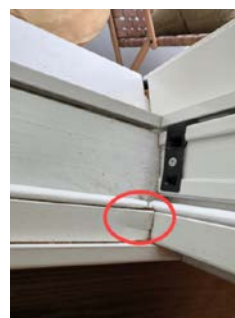
Foto viser skade i karm, kan legges til utetthet i overgang fasadeplater/ utvendig belistning - se andre utv. forhold.
