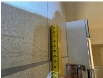
Foto viser sprang mellom fliser på vegg.
