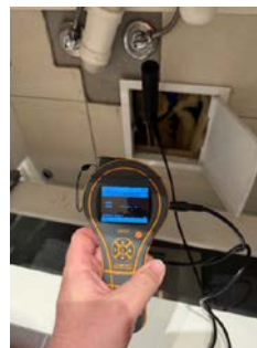
Foto: Fuktmåling i tilgjengelig trevirke.
