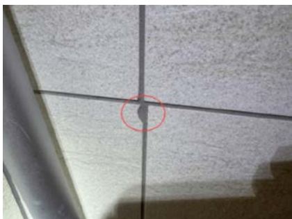
Foto viser kantskade i fliser på vegg.
