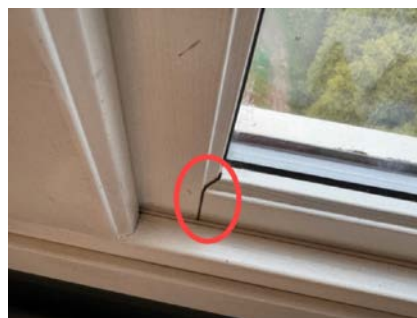
Foto viser skade i lukkekarm.
