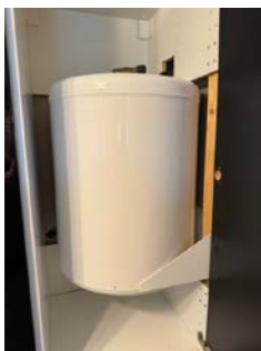
Foto viser hvor varmtvannsbereider i kjøkkenskap.
