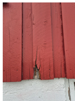
Råteskade i kledningsbord mot øst.
