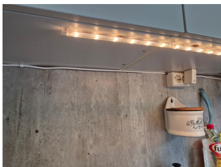
Synlig ufagmessig utførelse av ledninger.
