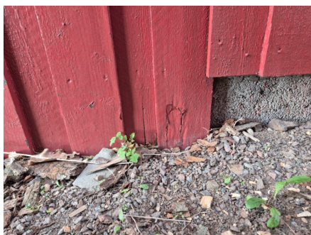
Kledningsbord går helt ned til terreng mot garasje og råte i bord.
