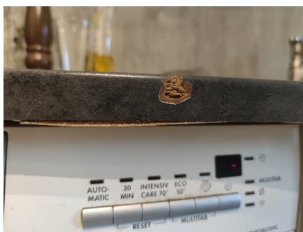
Skade i benkeplate.
