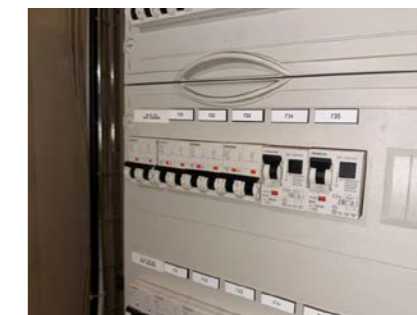
Sikringsskap plassert i felles oppgang.
