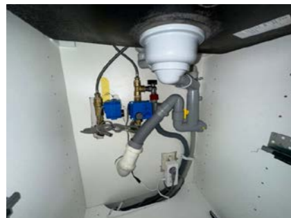
Rørøpplagg i kjøkkenbenk med Waterguard
