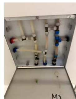
Samleskap med rørkurser og stoppekraner
