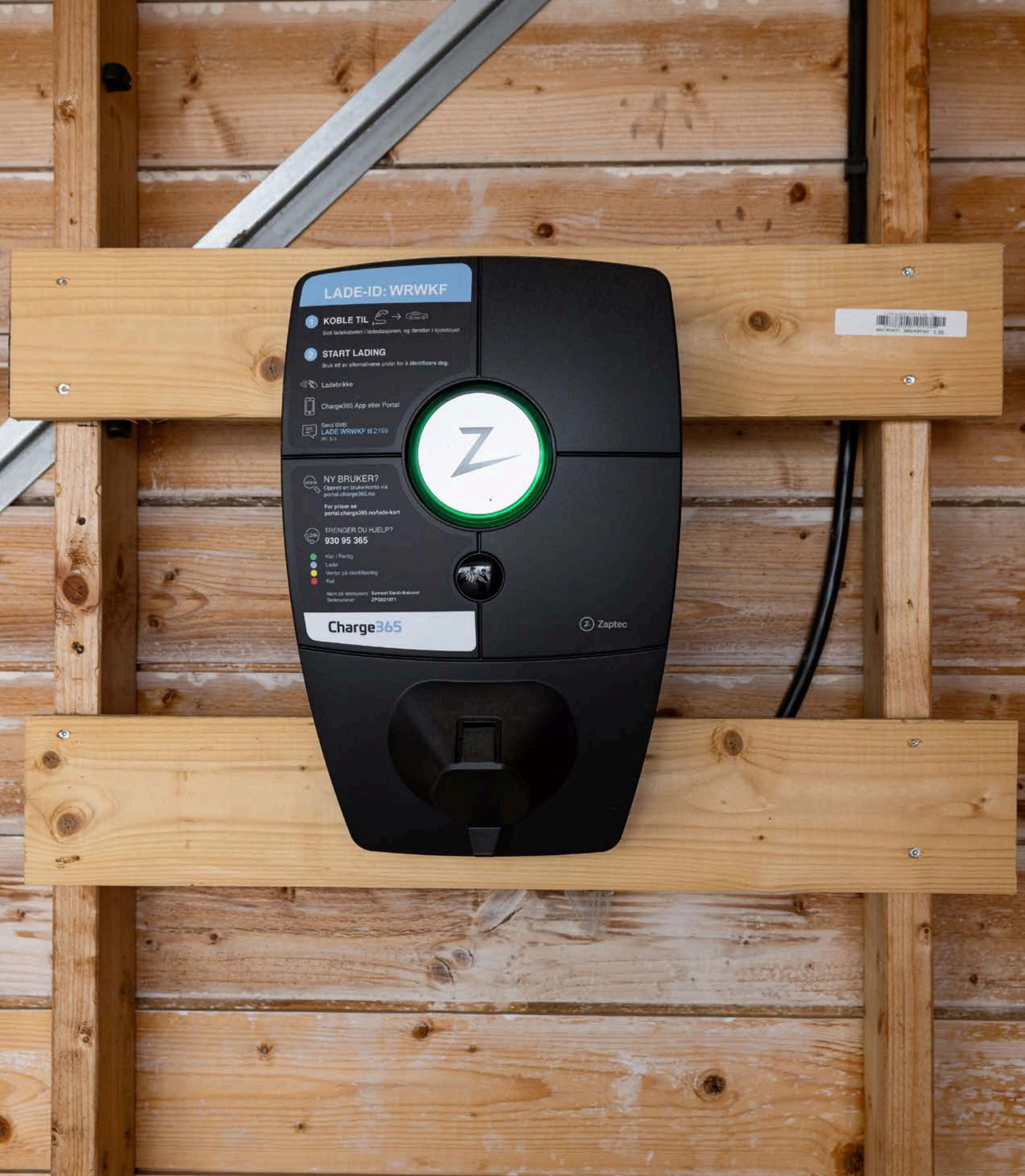
Montert ny elbil-lader i 2023.
