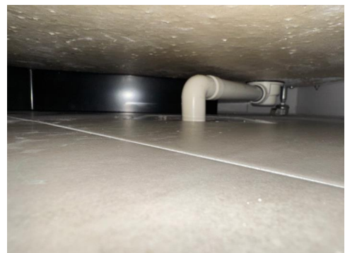
Sluk under dusjkabinett bad 2.etg.
