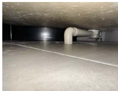
Sluk under dusjkabinett bad 2.etg.
