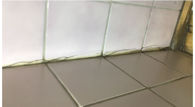
sprekte fliser i nedkant
