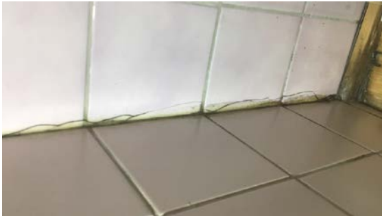
sprekte fliser i nedkant
