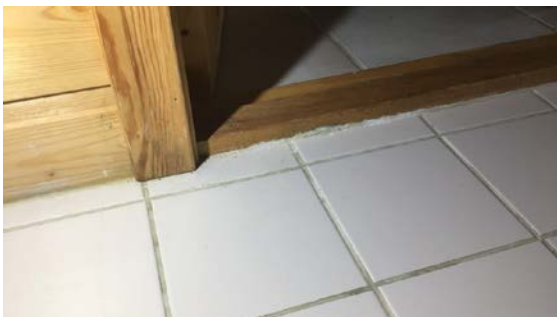
Mangler oppkant langs vegger og under dør
