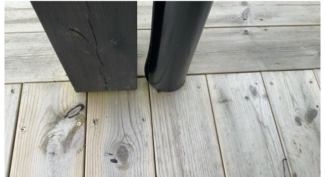
Frostsprengning på nedløpsrør
