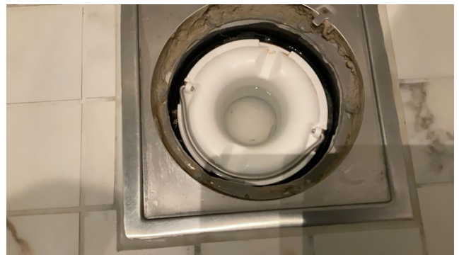
Sluk i dusjsonen
