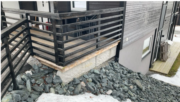
Store åpninger i rekkverk.
