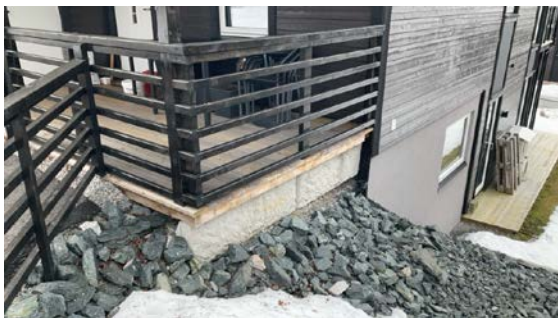
Store åpninger i rekkverk.
