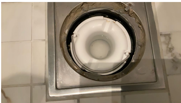
Sluk i dusjsonen
