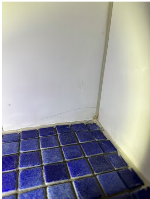
Viser sprukket flis i dusjsone.
