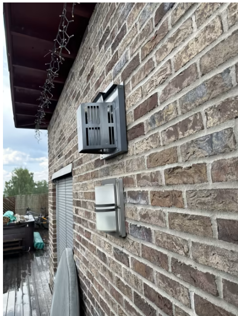
Avtrekk fra gasspeis.
