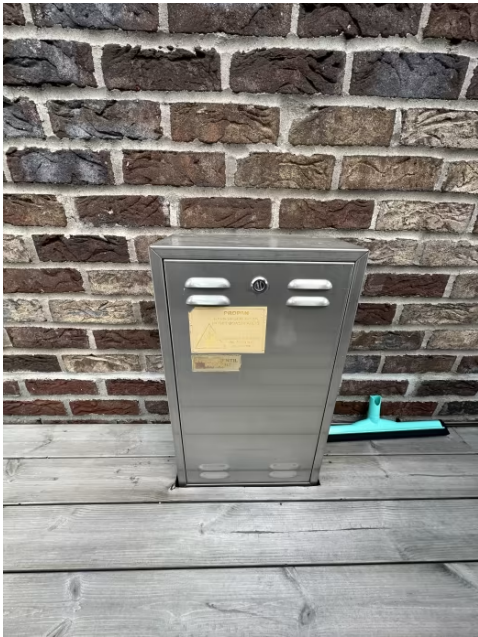
Viser stålkasse for gassforsyning og stengekran.
