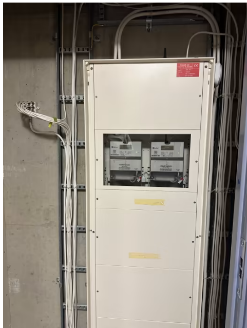
Strømmåler plassert i felles gangareal i 5 etasje.
