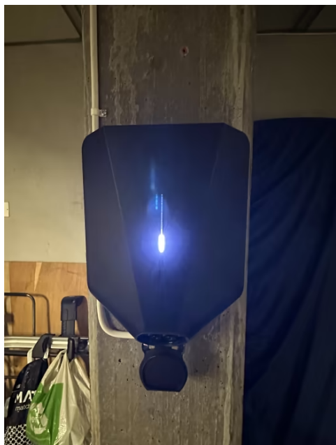
Viser El-bil lader på parkeringsplass.
