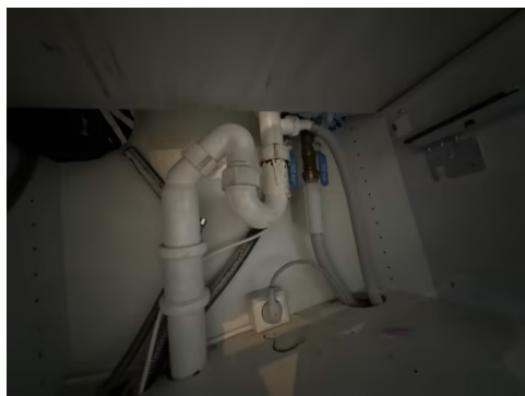
Viser vann- og avløpsinnstallasjoner under kum.
