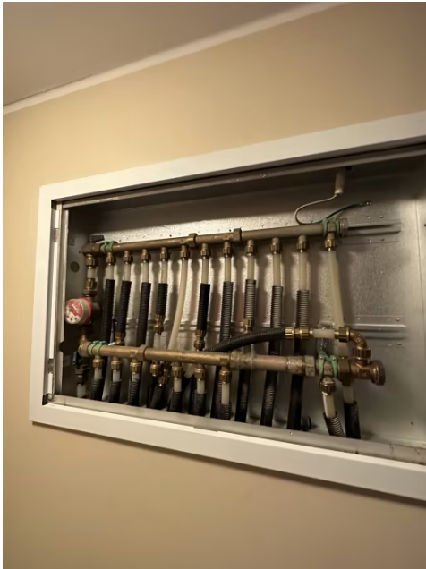
Viser innvendig innstallasjoner i fordelerskap. Stoppekran i skap.
