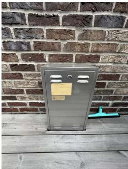
Viser stålkasse for gassforsyning og stengekran.
