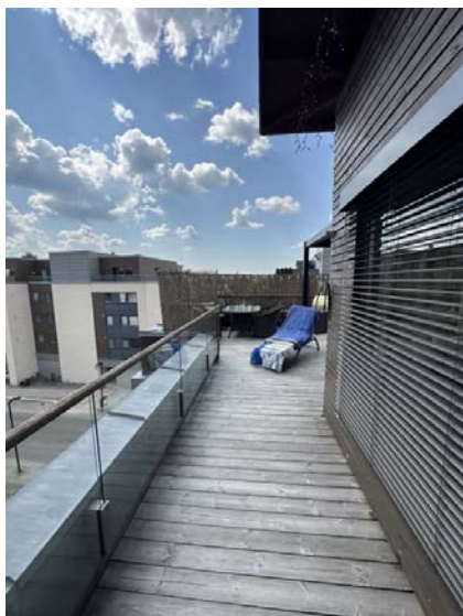
Viser glassrekkverk med håndløper i tre.
