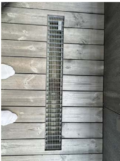
Viser rist og sluk på terrasse. Sluk må jevnlig rengjøres for å sikre god avrenning.
