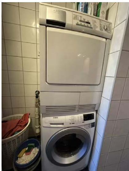
Viser opplegg for vaskemaskin og tørketrommel.
