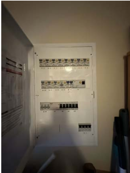
Viser innfelt sikringsskap plassert i bod.
