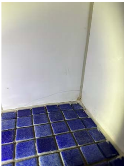
Viser sprukket flis i dusjsone.
