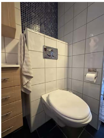
Viser vegghengt toalett med innebygget systerne.
