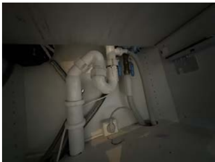
Viser vann- og avløpsinnstallasjoner under kum.
