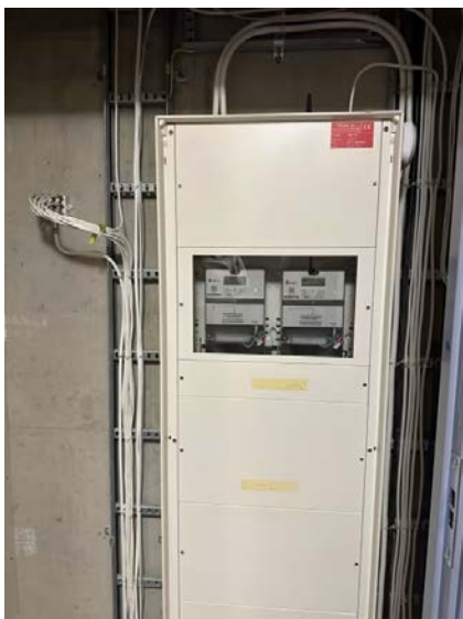
Strømmåler plassert i felles gangareal i 5 etasje.
