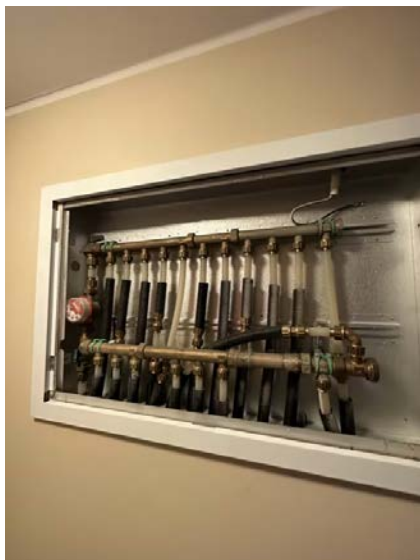
Viser innvendig installasjoner i fordelerskap. Stoppekran i skap.
