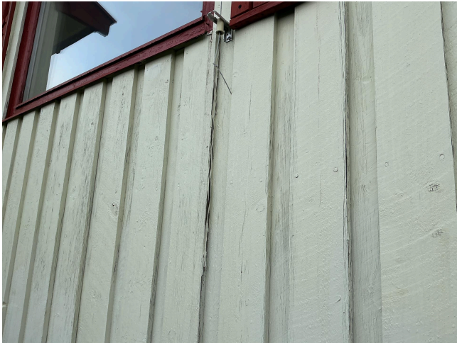
Manglende vedlikehold og dokumentasjon av kledning.
