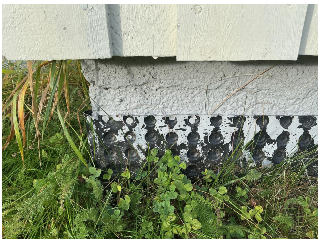
Feilmontert fuktsikring (vortepapp) på murkonstruksjon mot terreng.
