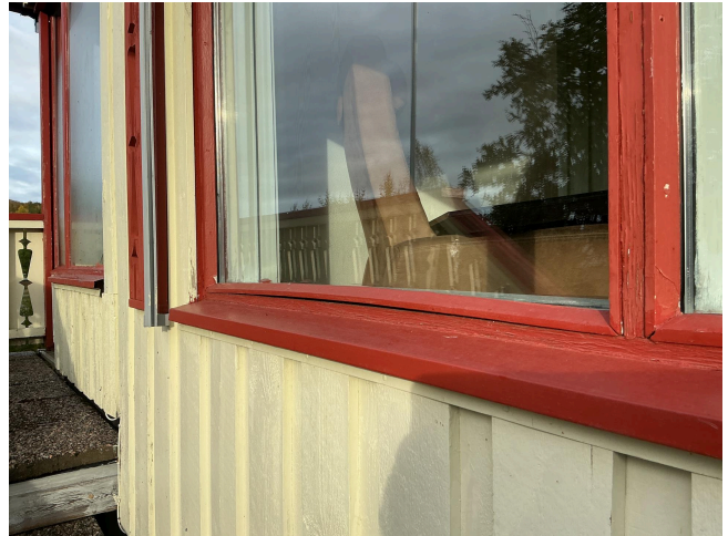
Feil avslutning av kledning mot beslag Manglende oppbrett i ender av beslag Vinduer av eldre dato – passert teknisk levetid
