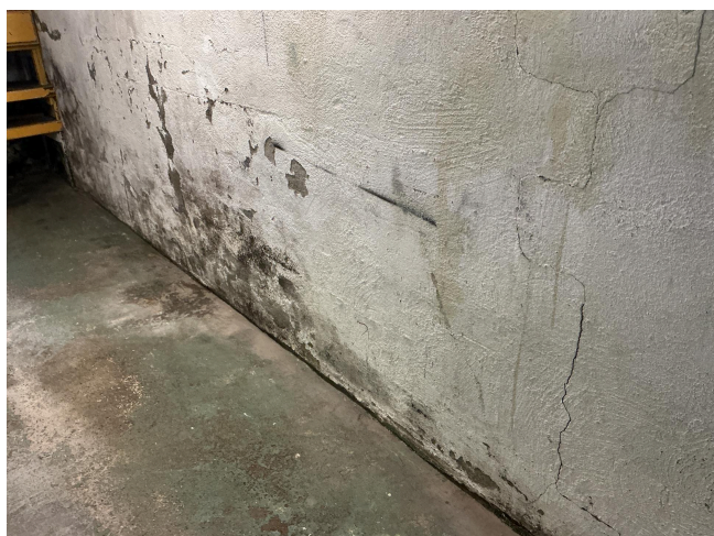
Fuktskjolder observert på veggoverflater. Symptomer på fukt, som misfarging og lukt. Svertesopp på enkelte områder av veggen.
