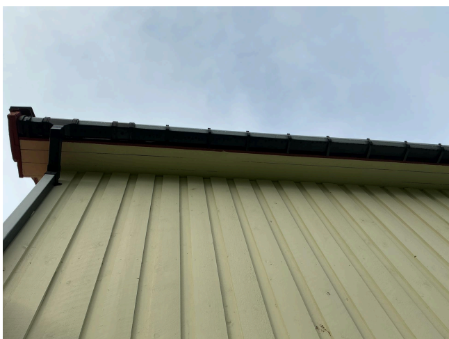
Manglende eller dårlig lufting av takkonstruksjon.
