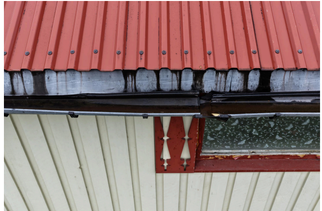
Manglende snøfangere eller annen taksikring.
