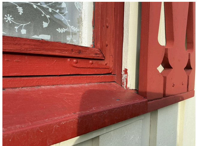
Feil avslutning av kledning mot beslag Manglende oppbrett i ender av beslag Vinduer av eldre dato – passert teknisk levetid Dører av eldre dato – passert teknisk levetid Slitasje på hengsler og lås Vanskelig å lukke/låse dører Råte eller deformasjon i dørblad/karm
