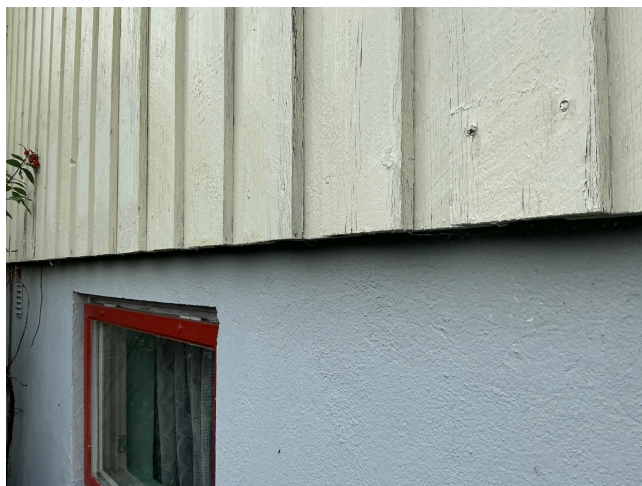
Manglende vedlikehold og dokumentasjon av kledning.
