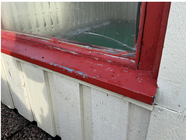
Feil avslutning av kledning mot beslag Manglende oppbrett i ender av beslag Vinduer av eldre dato – passert teknisk levetid Vanskelig å lukke/låse dører Råte eller deformasjon i dørblad/karm Sprekk i glass eller karm
