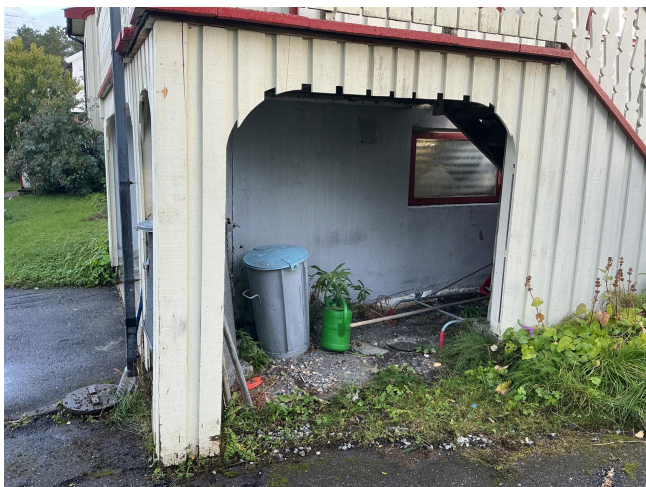
Skjevheter eller deformasjoner i vegg.
