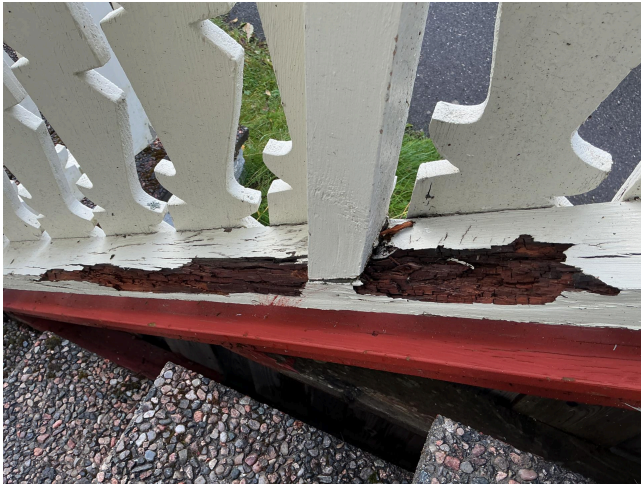
Råte i rekkeverket.
