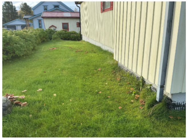
Alder og slitasje på eksisterende system. Overvann ledes mot bygning.
