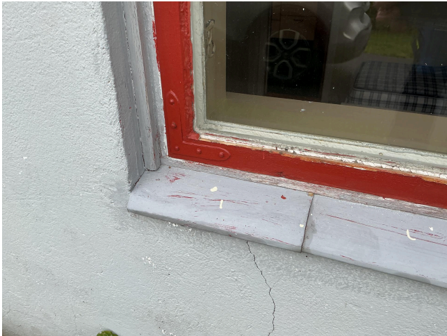
Manglende oppbrett i ender av beslag Vinduer av eldre dato – passert teknisk levetid
