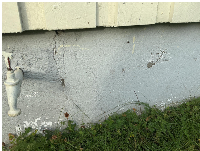
Setningsskader eller skjevheter. Sprekkdannelser i mur eller betong.
