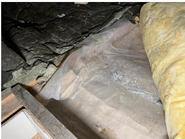
Dårlig isolering eller kuldebroer. Feilmontert eller manglende dampsperre.
