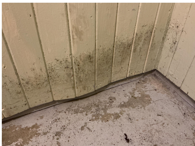
Fuktskjolder observert på veggoverflater. Symptomer på fukt, som misfarging og lukt.
