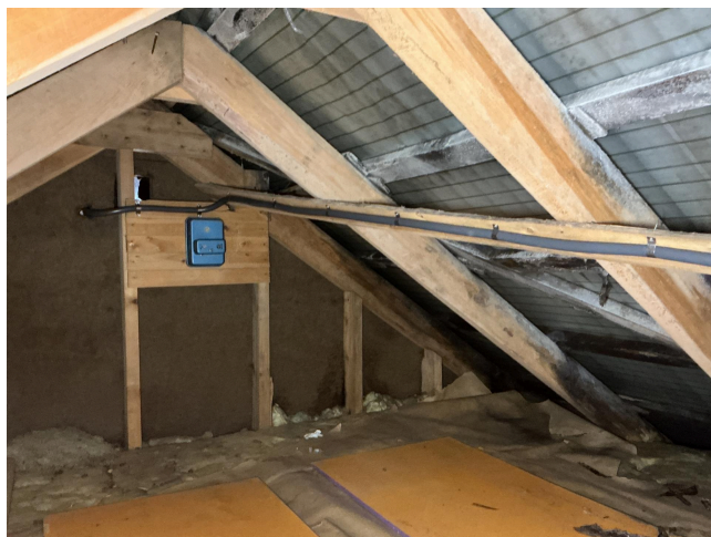
Tekking er lagt direkte på undertak uten luftespalte.
