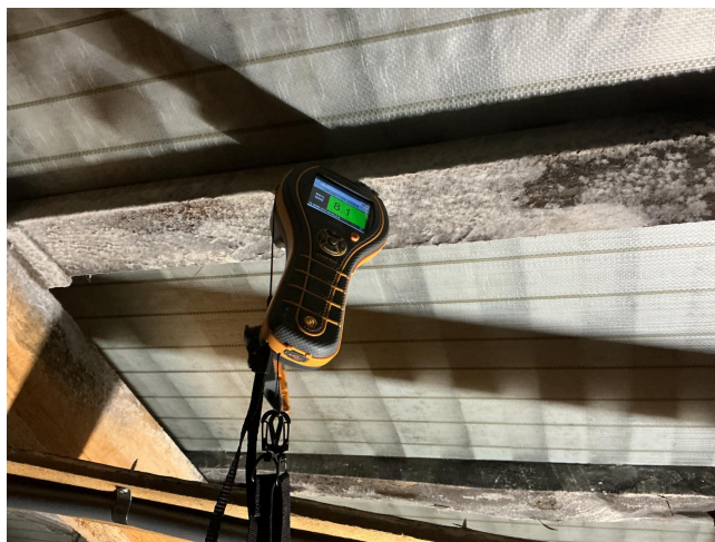
Manglende eller dårlig lufting av takkonstruksjon.
