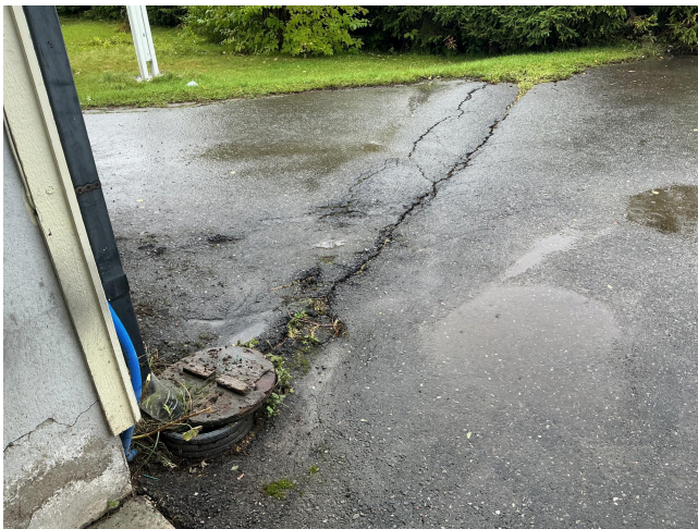
Alder og slitasje på eksisterende system.
