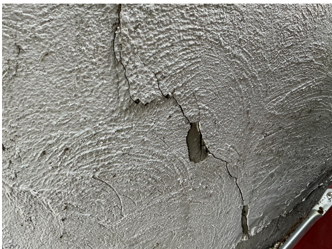
Flassing eller avskalling av maling.
