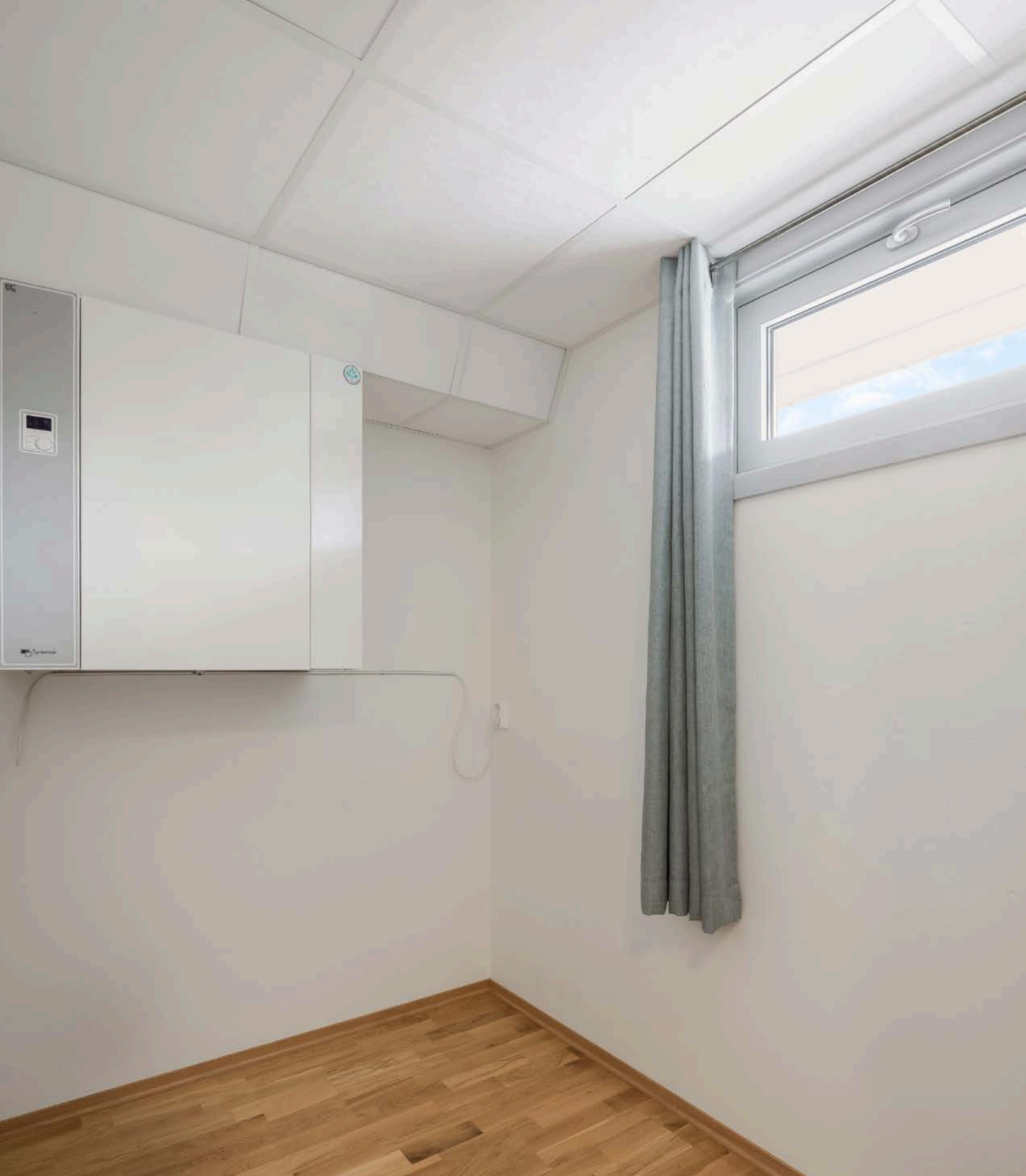
Innvendig bod/teknisk rom hvor anlegget for balansert ventilasjon er plassert.
