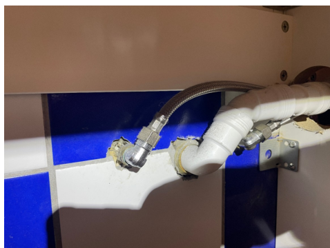
Mangelfull tetting rundt rør under vasken
