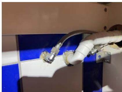
Mangelfull tetting rundt rør under vasken
