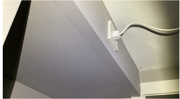
Noe ufagmessig sparkling av hjørnet.
