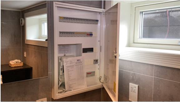
Sikringskap til hoveddel lokalisert på bad/vaskerom.
