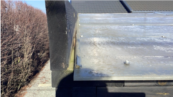
Enkelte løse lister på pergola tak.
