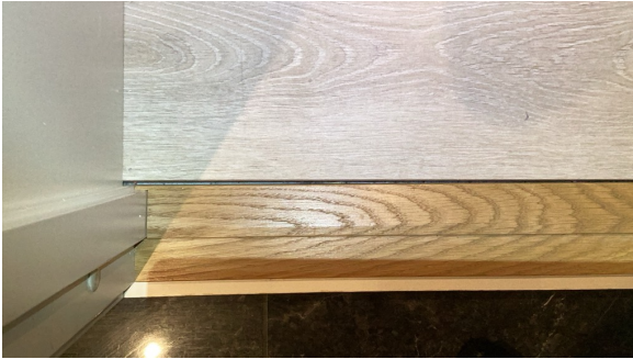
Mangler avslutningslist mot terskel.
