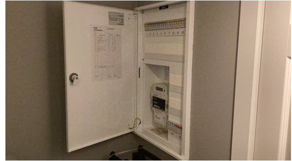
Sikringskap til utleiedel på bod.
