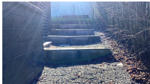
Noe skjevheter i trapp.
