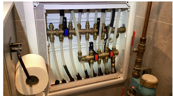
Fordelerskap på bad/vaskerom. Skruehull inne i skap bør tettes med egnet masse mtp vannsprut.
