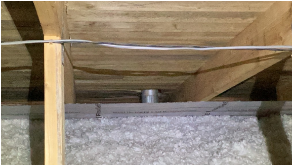
Noe misfarging på undertaksbord ved raft.
