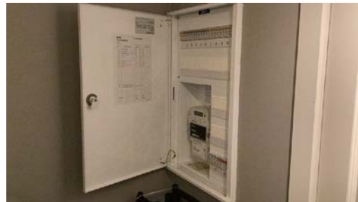
Sikringsskap til utleiedel på bod.
