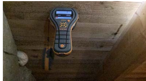
Fuktmåling ble foretatt, jeg målte skadelig fukt i undertaksbord enkelte steder.
