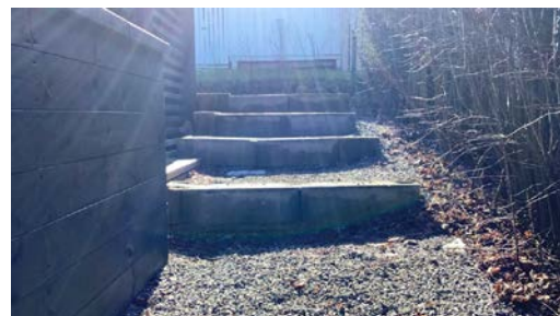
Noe skjevheter i trapp.
