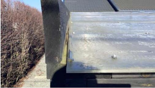
Enkelte løse lister på pergola tak.
