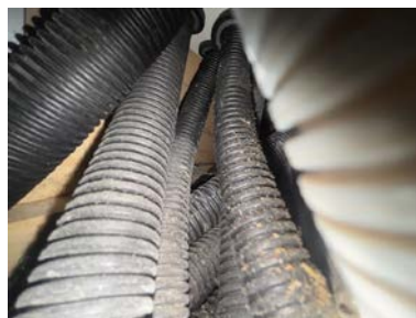
Bilde tatt med telefon, bildet er tatt inne i kasse som går under trapp og inn i vegg på badet.
