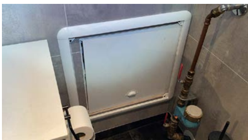
Fordelerskap er noe forskjøvet så sprutplate er vanskelig og få på plass.
