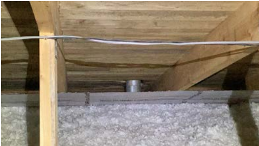
Noe misfarging på undertaksbord ved raft.
