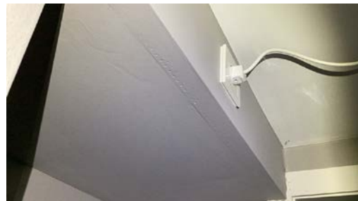
Noe ufagmessig sparkling av hjørnet.
