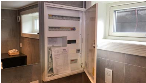
Sikringsskap til hoveddel lokalisert på bad/vaskerom.
