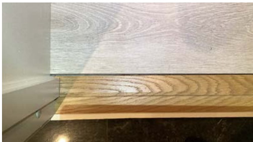
Mangler avslutningslist mot terskel.
