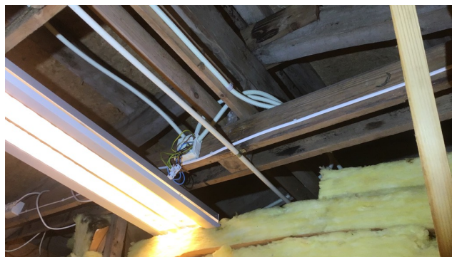
Løse og ubeskyttede ledninger
