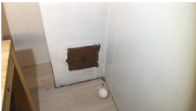
Mangler ildfast plate på vegg og gulv
