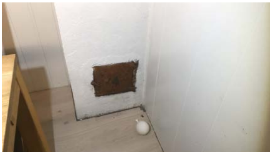
Mangler ildfast plate på vegg og gulv
