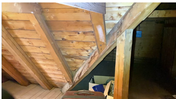
Fuktmerker på taksperrer.
