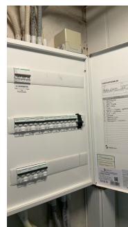
Sikringsskap plassert i teknisk rom.
