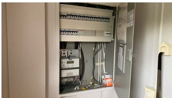
Sikringsskap plassert i entre.
