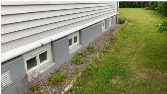
Viktig å følge med på vinduer som ligger helt ned mot terrenget, risiko for vanninntrenging ved snøsmelting og mye nedbør.
