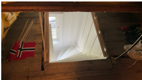
Trapp til loft er bratt og mangler håndløper.
