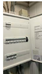
Sikringsskap plassert i teknisk rom.
