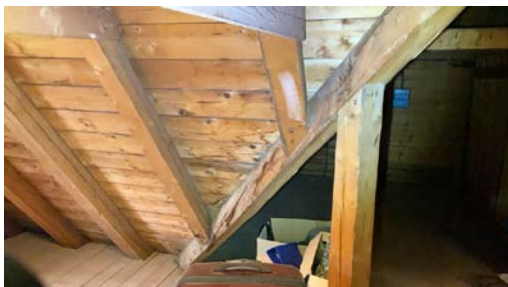
Fuktmerker på taksperrer.
