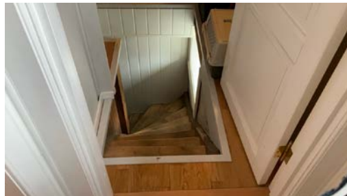
Trapp til kjeller mangler håndløper. Trapp internt i boenhet er smalere enn 80cm.
