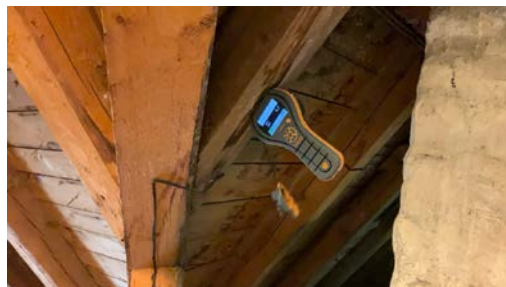
Fuktmerker er registrert ved gjennomføringer. Det er usikkert om fuktmerker skyldes eldre eller nyere vanngjennomtrengning. Fuktmerker kan ha oppstått ved spesielle værforhold. Ved fuktmåling registrerte jeg ikke unormale verdier.
