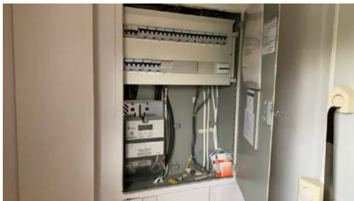
Sikringsskap plassert i entre.
