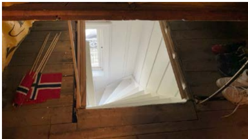
Trapp til loft er bratt og mangler håndløper.
