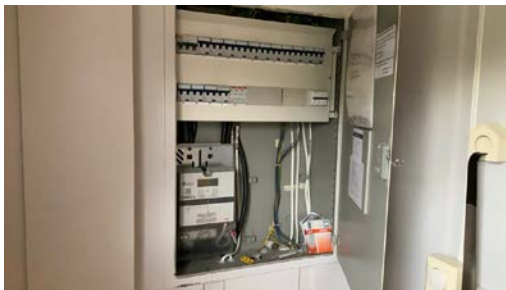
Sikringsskap plassert i entre.
