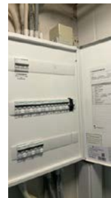
Sikringsskap plassert i teknisk rom.
