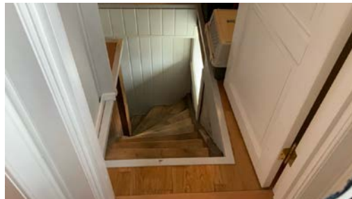
Trapp til kjeller mangler håndløper. Trapp internt i boenhet er smalere en 80cm.
