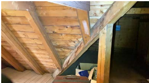
Fuktmerker på taksperrer.
