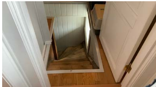
Trapp til kjeller mangler håndløper. Trapp internt i boenhet er smalere en 80cm.
