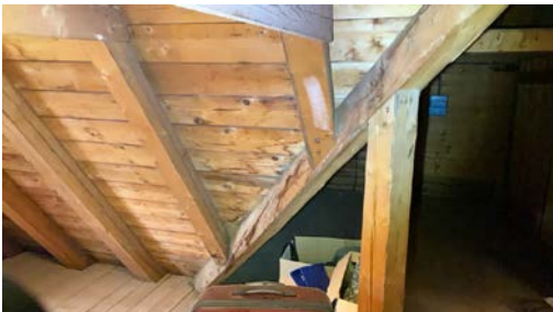
Fuktmerker på taksperrer.
