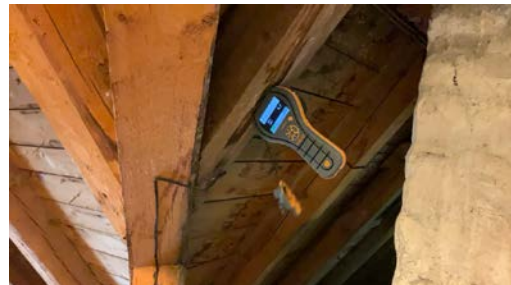
Fuktmerker er registrert ved gjennomføringer. Det er usikkert om fuktmerker skyldes eldre eller nyere vanngjennomtrengning. Fuktmerker kan ha oppstått ved spesielle værforhold. Ved fuktmåling registrerte jeg ikke unormale verdier.
