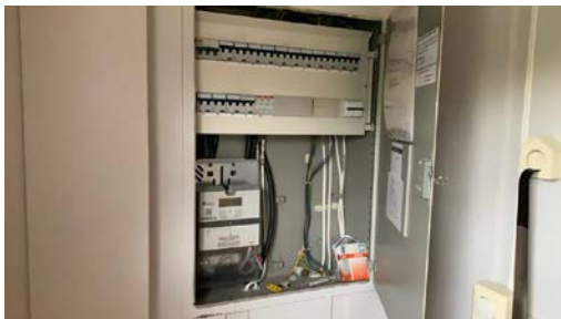
Sikringsskap plassert i entre.
