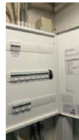
Sikringsskap plassert i teknisk rom.
