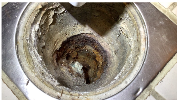
Støpejernsluk, og det er ikke synlig tettesjikt.
