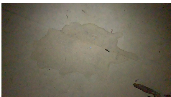
Eksempel på fuktskjolder på spongulv.
