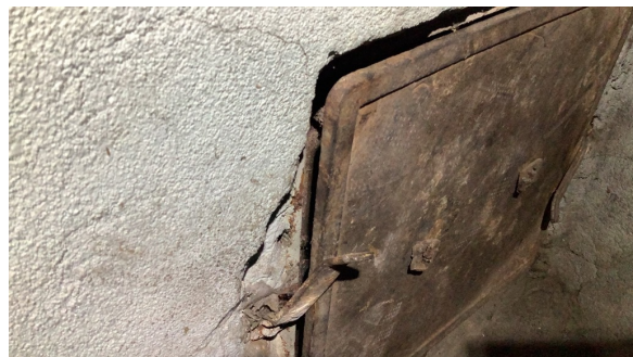
Sotluke ser ikke ut til å tette tilfredsstillende.
