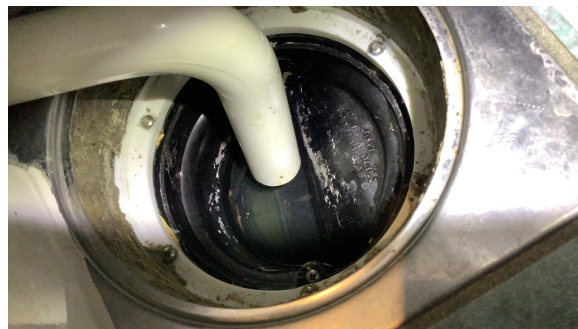
Plastsluk under badekar, og det observeres noe tettesjikt ført under deler av slukets klemring.
