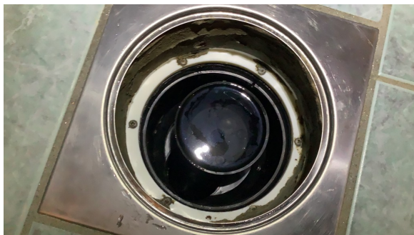
Plastsluk i dusjhjørnet, og det er ikke synlig tettesjikt.
