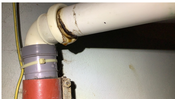
Lekkasje fra avløp.
