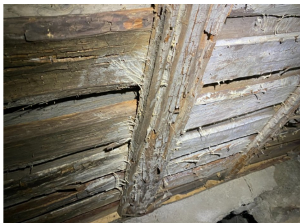
Sopp- og råteskader i bjelkelaget
