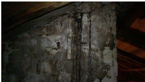
Rennemerker etter sotvann på loft.
