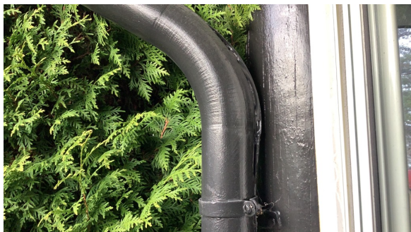
Eksempel på frostsprengt nedløpsrør.
