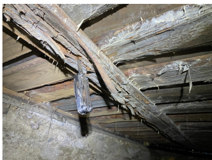
Sopp- og råteskader i bjelkelag under soverom.
