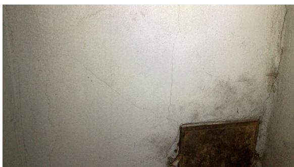
Eksempler på riss i pipe.
