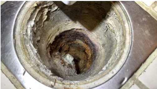
Støpejernsluk, og det er ikke synlig tettesjikt.
