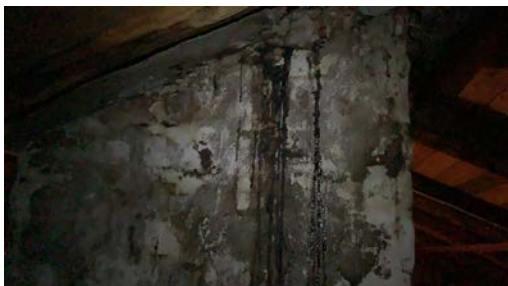
Rennemerker etter sotvann på loft.
