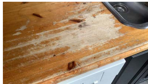
Slitasje i benkeplate.
