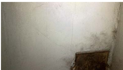
Eksempler på riss i pipe.
