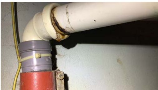
Lekkasje fra avløp.
