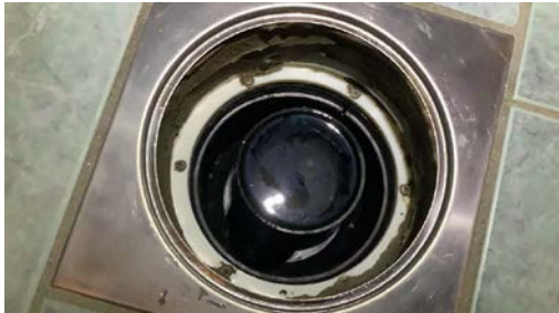
Plastsluk i dusjhjørnet, og det er ikke synlig tettesjikt.
