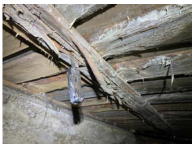
Sopp- og råteskader i bjelkelag under soverom.
