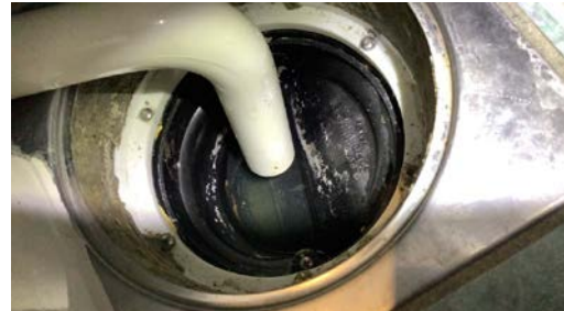
Plastsluk under badekar, og det observeres noe tettesjikt ført under deler av slukets klemring.
