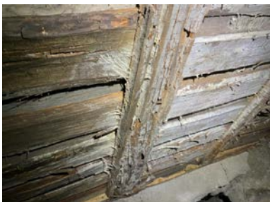
Sopp- og råteskader i bjelkelaget
