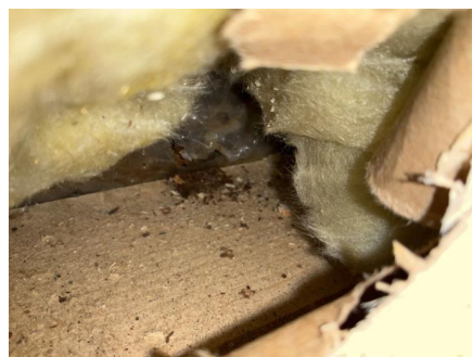
Indikasjoner på råteskader i konstruksjonen utenfor dampspærren mot dusjsone på badet.
