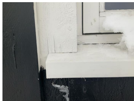
Omrammning rundt vinduer er ført ned på beslag, risiko for fuktopptrekk i treverket.
