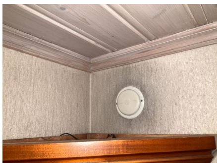
Det er påvist heksesot/støvkondens på overflater
