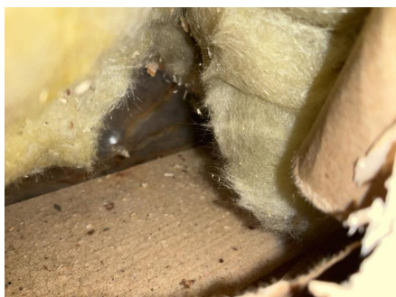
Dampspærre er perforert med spiker.
