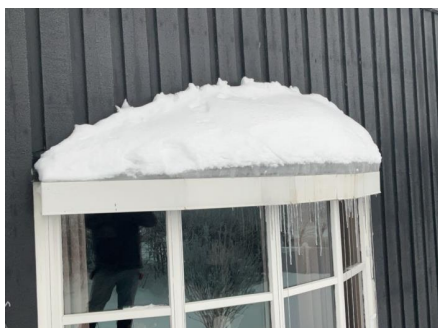
Det registreres isdannelse på karnapp. Dette er et symptom på dårlig isolering/lufting. Dette kan føre til fuktskader i konstruksjonen.
