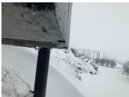
Endeved på utvendig kledning har enkelte steder ikke dryppkant, dette forkorter kledningens levetid.
