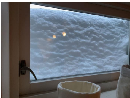
Lav høyde mellom terreng og kjellervinduer.
