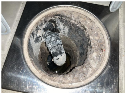
Ingen tegn til tettesjikt/membran i sluket
