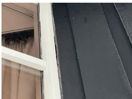
Ikke tilstrekkelig tetting rundt vinduer i karnapp. Dette kan føre til kald trekk, fuktskader og økte fyringsutgifter.
