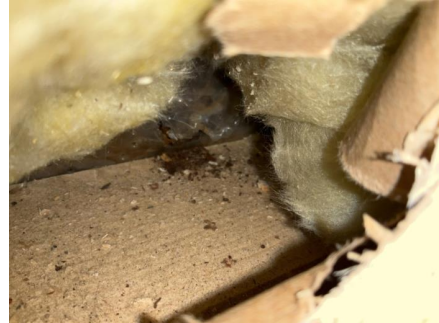
Det er i hulltakingen påvist fukt/råteskader
