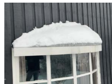
Det registreres isdannelse på karnapp. Dette er et symptom på dårlig isolering/lufting. Dette kan føre til fuktskader i konstruksjonen.
