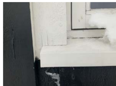
Omranning rundt vinduer er ført ned på beslag, risiko for fuktopptrekk i treverket.
