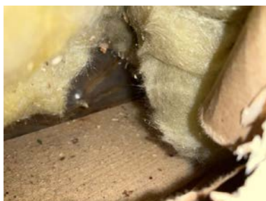
Dampspærre er perforert med spiker.
