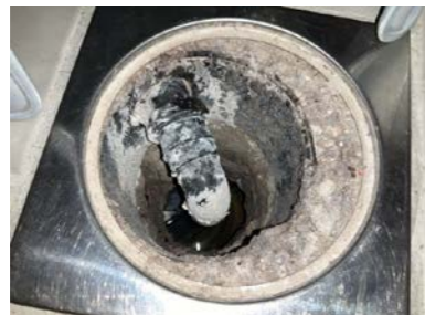
Ingen tegn til tettesjikt/membran i sluket
