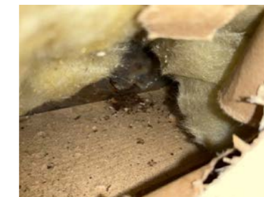
Det er i hulltakingen påvist fukt/råteskader
