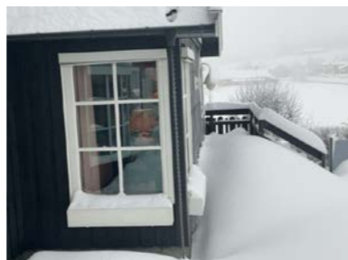
Taknedløp i kjetting. Det er ikke tilfredsstillende bortledning av vann fra taknedløp ved grunnmur.
