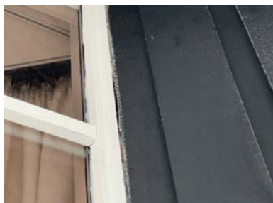
Ikke tilstrekkelig tetting rundt vinduer i karnapp. Dette kan føre til kald trekk, fuktskader og økte fyringsutgifter.
