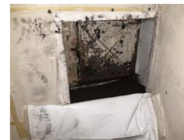
Sotluke er ikke helt tett. Det trekker fra luke og det siver ut aske. Tildekket med plastfolien på befaringsdagen.
