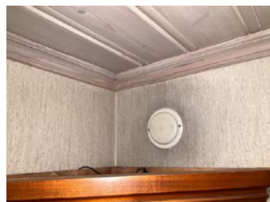
Det er påvist heksesot/støvkondens på overflater
