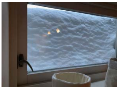
Lav høyde mellom terreng og kjellervinduer.
