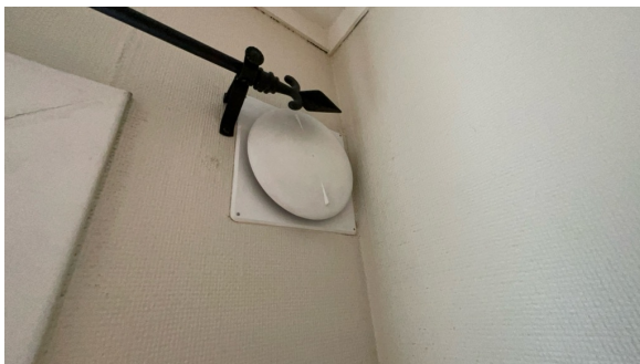
Eksempel på montert ventil i vegg.
