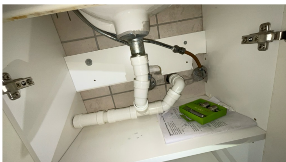
Del av rør til vann.
