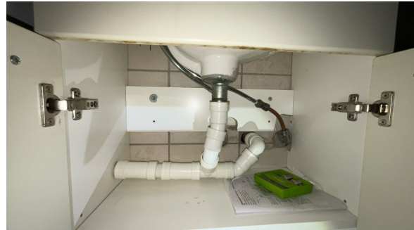
Del av rør til avløp.
