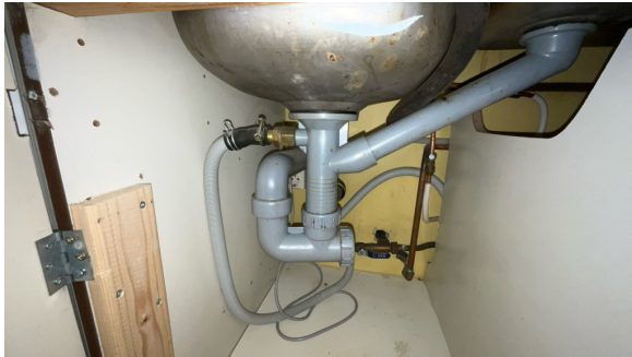
Del av rør til avløp.
