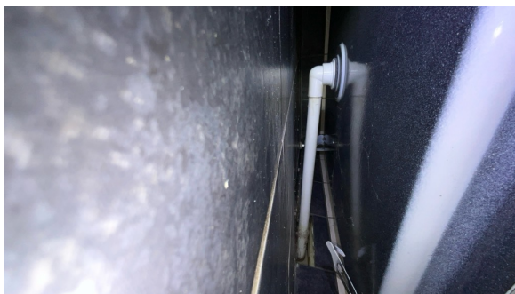
Del av rør til avløp under dusjkabinett.
