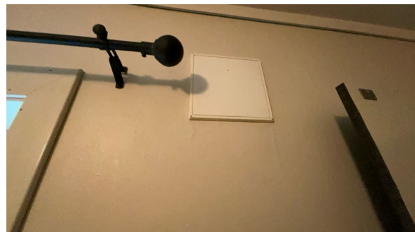
Eksempel på montert ventil i vegg.
