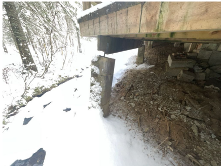
Skjevhet i pilar til altan.
