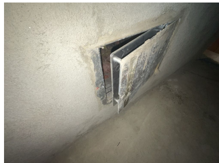
Manglende lukkemulighet på feieluke.
