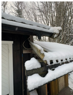
Råte i vinds kier og improvisert beslag ved hovedinngang.
