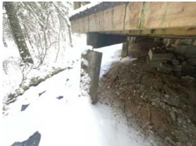
Skjevhet i pilar til altan.
