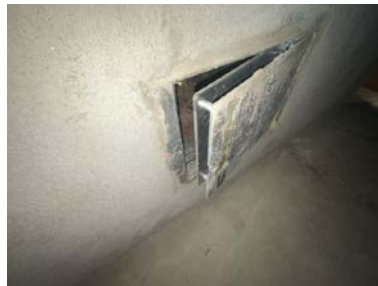
Manglende lukkemulighet på feieluke.
