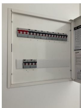
Sikringsskapet til hybelen er utstyrt med automatsikringer.
