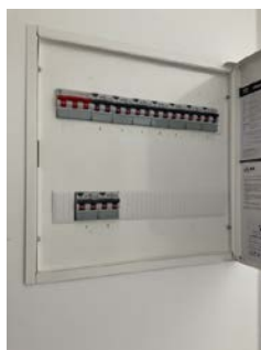
Sikringskapet til hybelen er utstyrt med automatsikringer.
