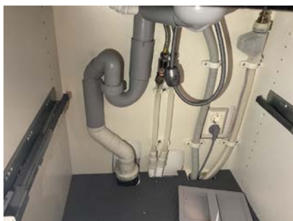
Synlige rør under kjøkkenbenken.
