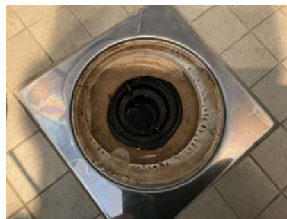
Plastsluk i gulv.
