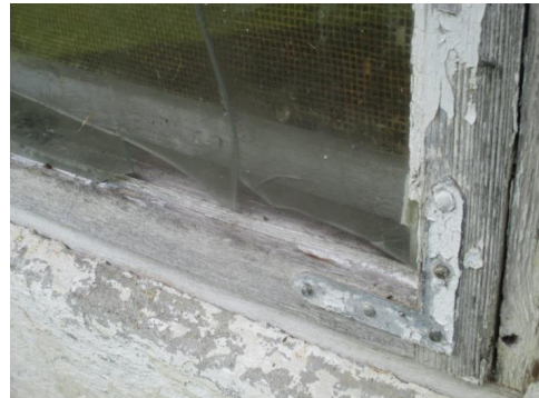
Eldre slitte/skadet kjellervinduer under opprinnelig del.
