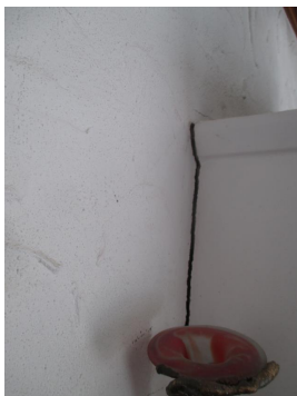
Har glidd noe i fra brannmur på kjøkken.
