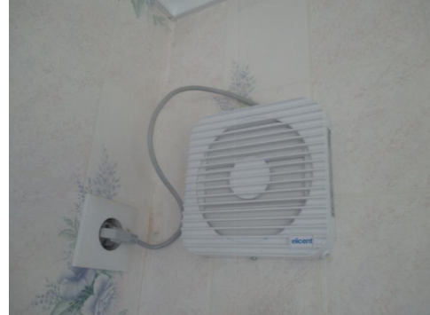
Vifte i ytterveggen.
