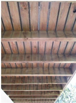
Noe lagt overheng på bjelker uten for drager.
