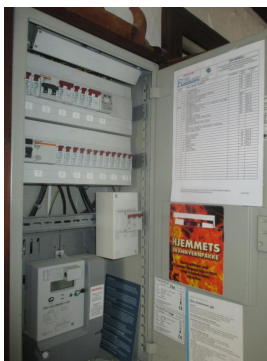
Hoved sikringskapet er plassert i hall.
