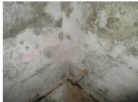
Fuktighet i ene ytterhjørne i opprinnelig del.
