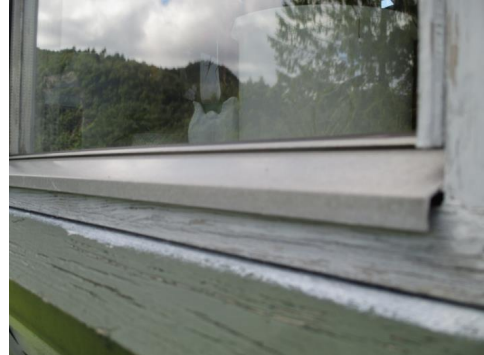
Noe slitasje på karm og ramme.
