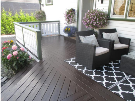
Større plattning ved inngangsparti.
