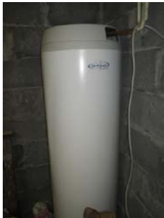
Stor nyere bereder i grovkjeller.
