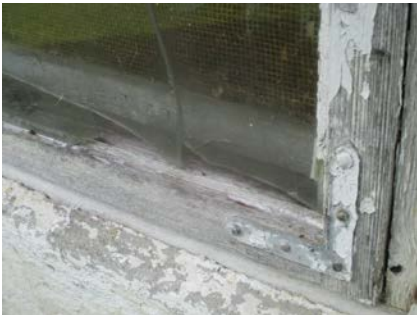
Eldre slitte/skadet kjellervinduer under opprinnelig del.
