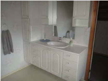
Innredningen har svellet noe på enkelte fronter.
