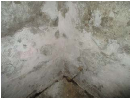
Fuktighet i ene ytterhjørne i opprinnelig del.
