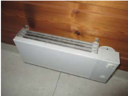
Panelovn på veggen.
