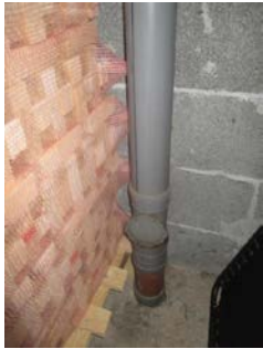
Avløpsrør av plast med stakeluke.
