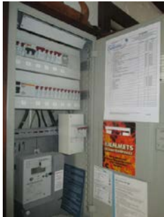
Hoved sikringsskapet er plassert i hall.
