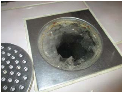
Sluk ved toalett.
