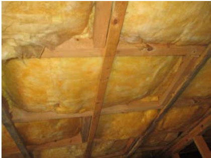
Underliggende himling i kjeller er ikke platekledd.
