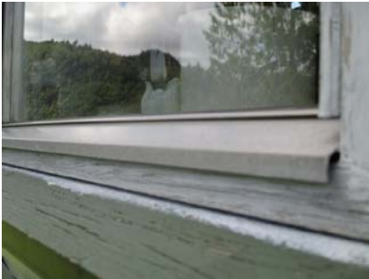
Noe slitasje på karm og ramme.
