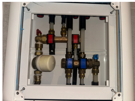
Samleskap med rørkurser og stoppekraner
