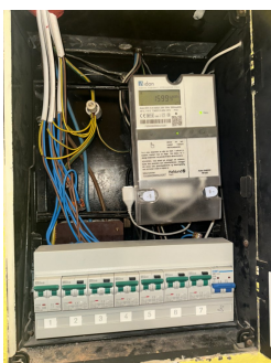
Sikringsskap med automatsikringer.
