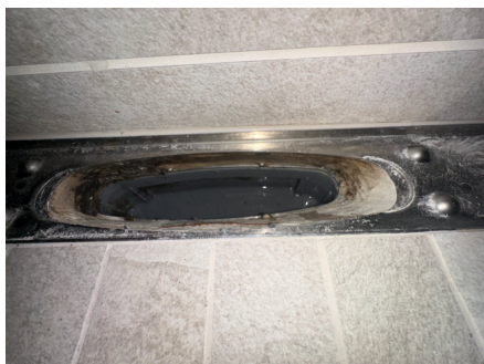
Slukrenne plassert i dusjnisje
