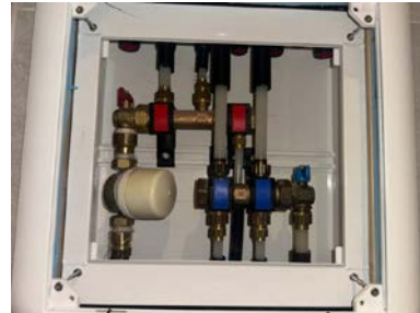
Samleskap med rørkurser og stoppekraner
