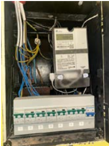
Sikringsskap med automatsikringer.
