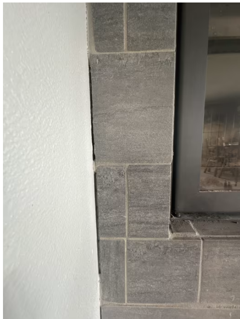
Noe gjenstående arbeid ved overgang/ avslutninger.
