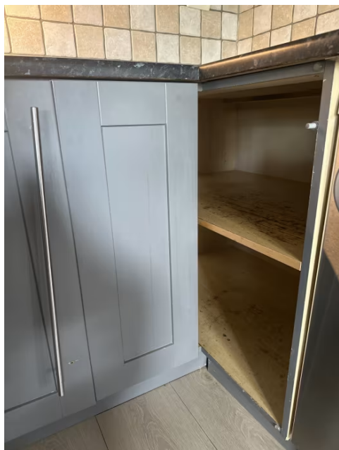
Håndtak er løst og front mangler.
