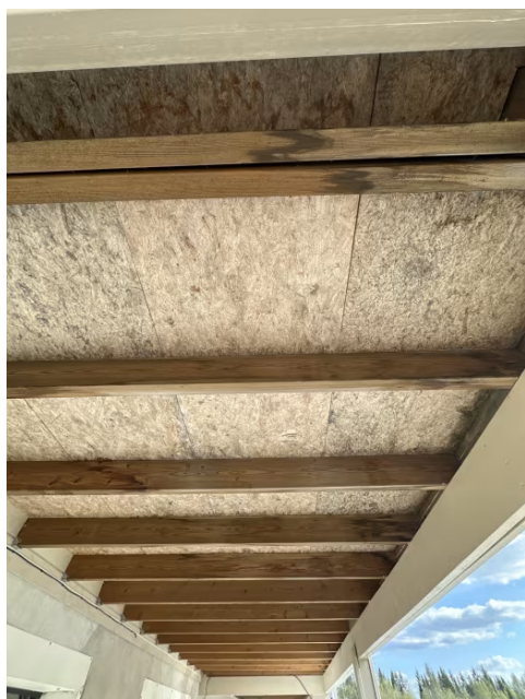
Det registreres svelling og fuktskjolder på plater under veranda.
