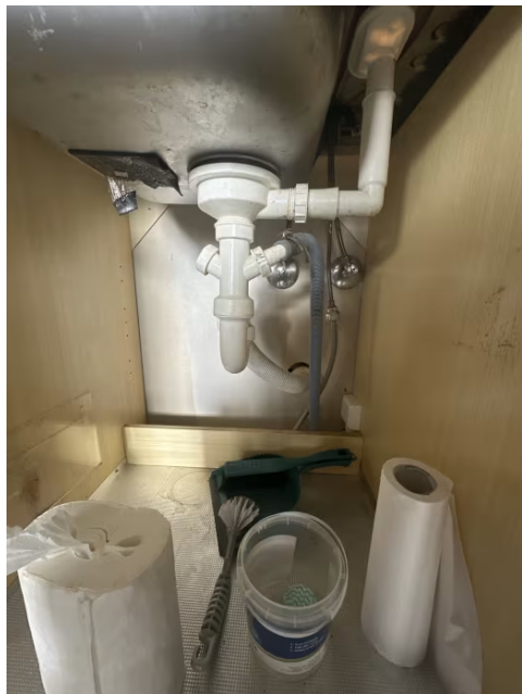
Viser vann og avløpsinnstallasjoner under kum.
